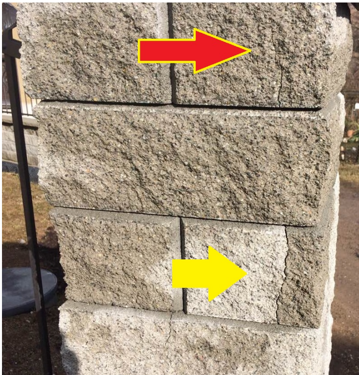
Obr.2: CASSER - nevhodný typ použitého betónu resp. nevhodne použitá oceľová zvislá výstuž - - do výplňového betónu sa dostala voda, vplyvom objemových zmien vody prišlo k popraskaniu tvárnic
